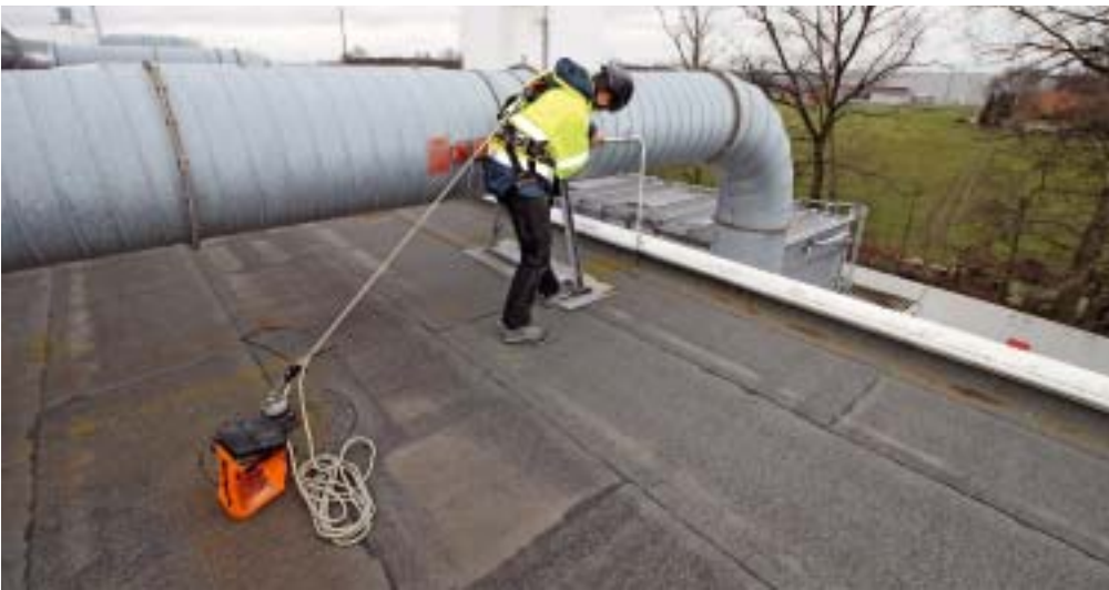
Rückhaltesysteme begrenzen den Arbeitsraum des Anwenders und verhindern so den Sturz über die Dachkante.
